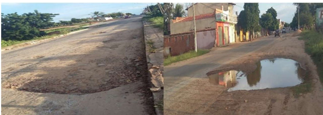
Figura 5. Presença de panelas no trecho
