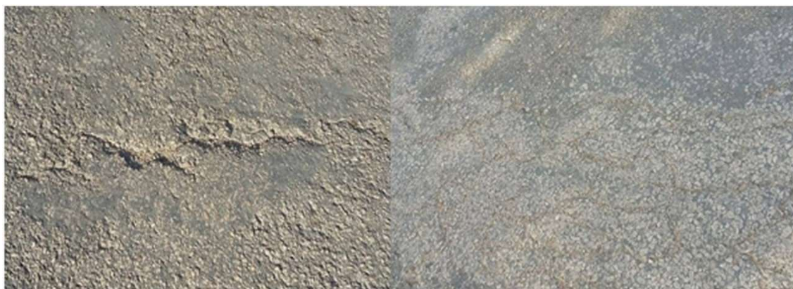
Figura 3. Presença de fendas no pavimento
