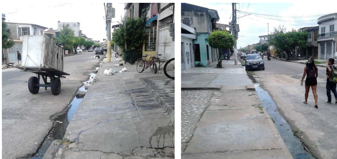
Figura 13. Vista de declividade transversal maior que 8.33%
