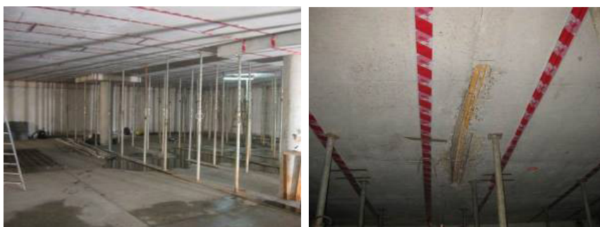
Figuras 17 y 18 – Vista del sector de estudio y desprendimientos.
