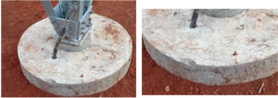
Figura 1 - Base de concreto onde fica nítida a fissuração superficial, provavelmente devida à retração por secagem do graute colocado na parte superior.
