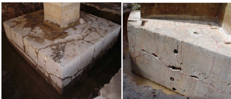
Figura 1: Fissuração de bloco de fundação afetado pelo RAA.
