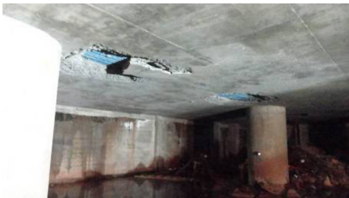
Figura 15 – Desprendimiento de hormigón debajo de los cabos.
