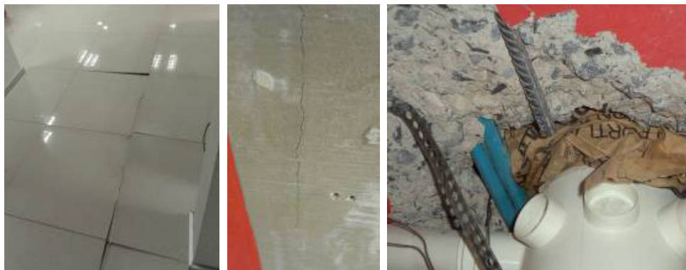
Figuras 24, 25 y 26. Desprendimientos de pisos y fisuras y desprendimientos en losas.
