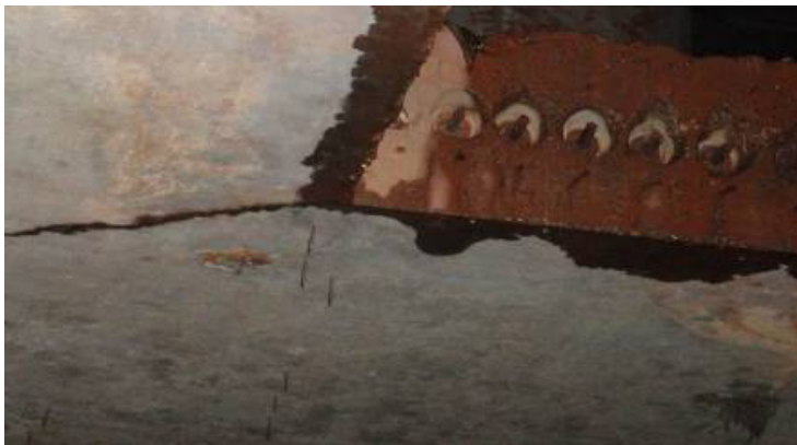
Figura 14 – Fisura en esquina de losa.
