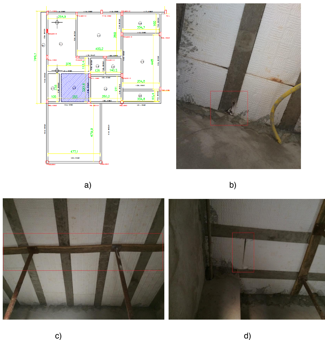
Figura 13 – a) Localização em planta da laje estudada, b) Treliça danificada, c) Deformação da laje, d) Fenda entre blocos de isopor
