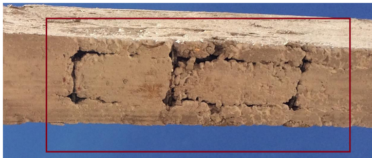
Figura 6 – Evidências de segregação em viga
