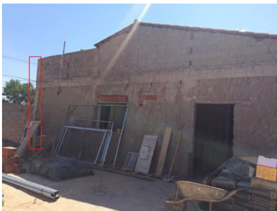
Figura 5 – Pilar desalinhado verticalmente
