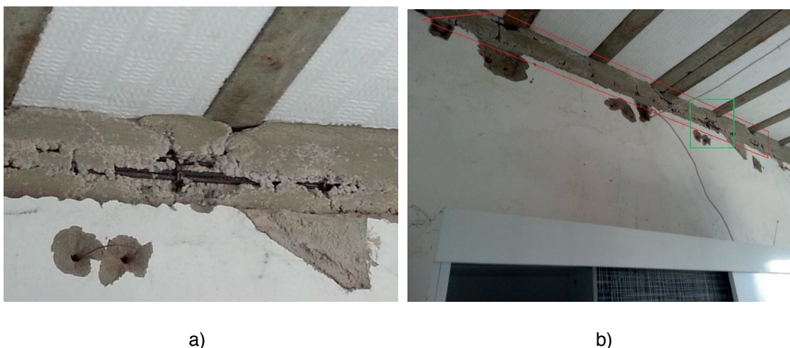
Figura 8 – a) Detalhamento da viga com falta de cobertura das barras e perda de altura útil, b) Viga do quarto com armadura exposta, segregação do concreto (vermelho) e perda de altura útil com exposição das barras (verde)
