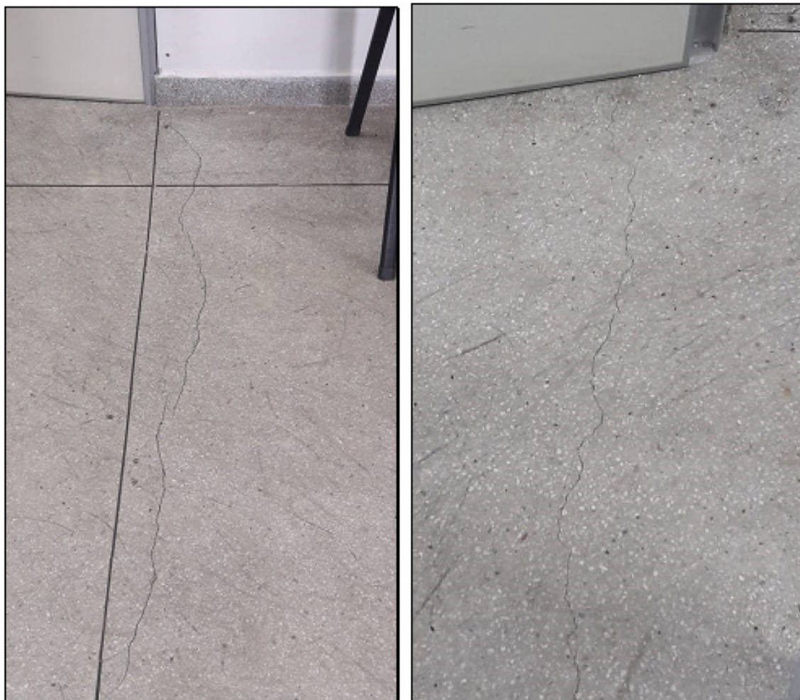
Figura 4 - Fissuras na Laje Superior / piso.
