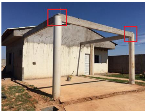
Figura 4 – Falta de ligação dos pilares com elementos horizontais
