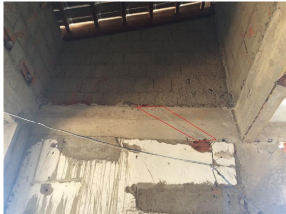
Figura 10 – Viga fissurada em 45 graus com a horizontal (vermelho) e fissura vertical na alvenaria cerâmica
