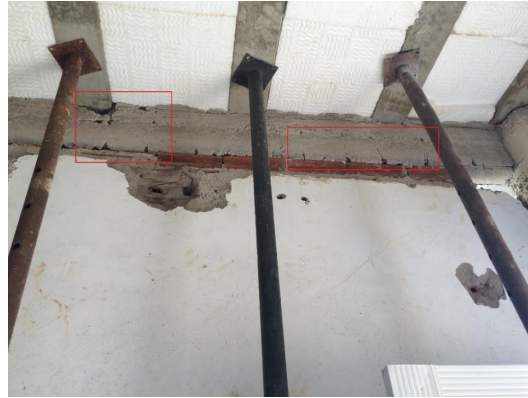
Figura 11 – Fissuras por extensão da face inferior da viga (vermelho)
