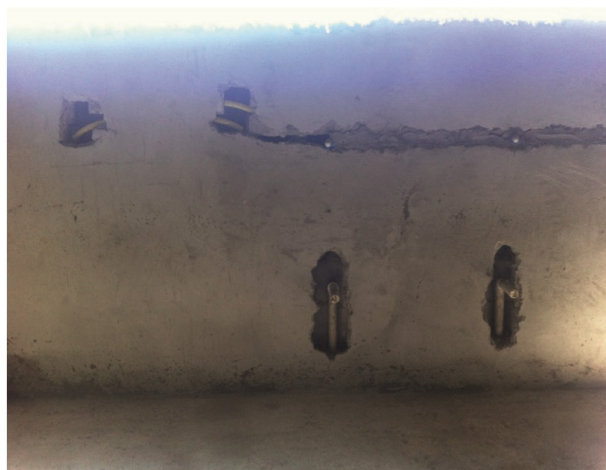
Figura 4 - Perda de materiais nos pontos de energia e água fria (CORREIA et al. (2017))
