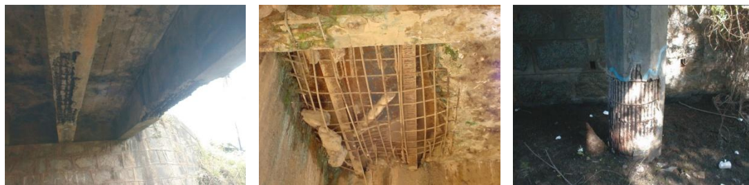
Figura 5.36 – Elementos problemáticos: viga, laje e pilar. Vigas da ponte s/ Rio Tapacurá, BR-232/PE, Km 50 - (1979) Laje da ponte s/ Rio Paraibuna, BR-267/MG, Km 89 - (1965) Pilar da ponte s/ Riacho Pão de Açúcar, BR-104/PE, Km 20 – (1965)
