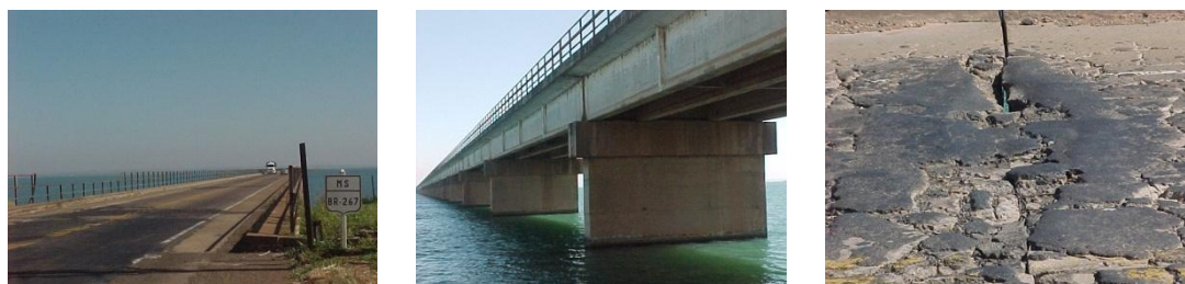
Figura 5.50 – Ponte Maurício Joppert, BR-267/MS, Km 0 – (1965) Condição de estabilidade: Boa - Condição de conservação: Precária
