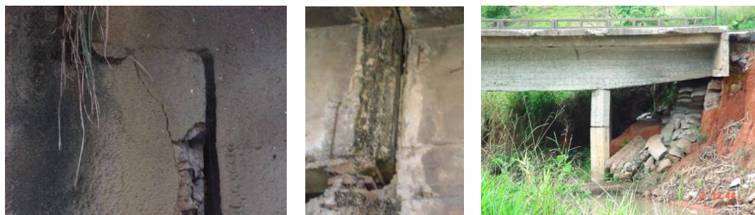
Figura 5.37 – Elementos problemáticos: dente Gerber, apoio e pilar Dente Gerber ponte s/ Rio Jequitinhonha, BR-101/BA, Km 663 (1965) Apoio da ponte s/ Rio Gravataí, BR-116/RS, Km 270 (1950) Pilar c/ desaprumo da ponte s/ Rio Preto - Norte, BR-101/ES, Km 30 (1958)
