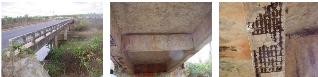
Figura 5.27 – Ponte sobre o Rio Camurupim, BR-402, Km 79, Camurupim de Cima – PI, em condição de estabilidade precária (1965)
