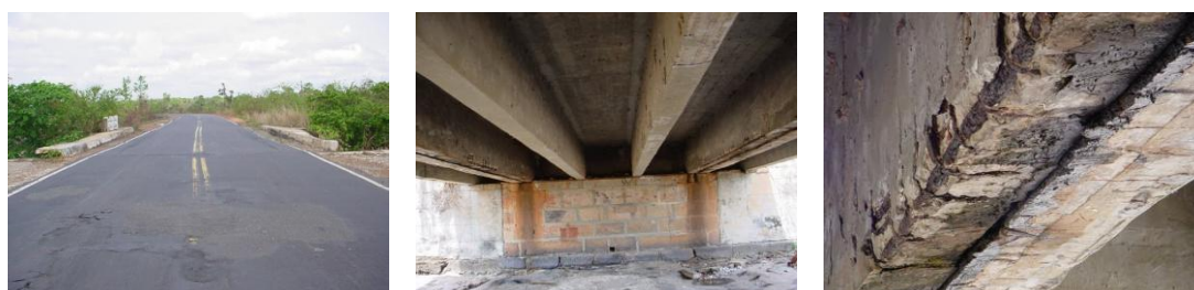
Figura 5.26 – Ponte sobre o Rio Raposo, BR-343, Km 294, Altos – PI, em condição de estabilidade sofrível (1938)
