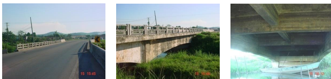
Figura 5.52 – Ponte s/ o Rio Magé, BR-493/RJ, Km 20 – (1952) Condição de estabilidade: Sofrível - Condição de conservação: Sofrível
