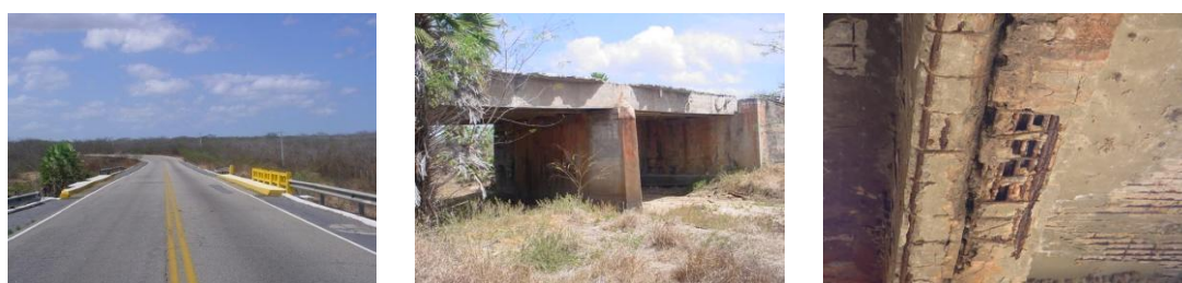
Figura 5.53 – Ponte s/Riacho Juazeirinho, BR-116/CE, Km 88 – (1932) Condição de estabilidade: Sofrível - Condição de conservação: Precária
