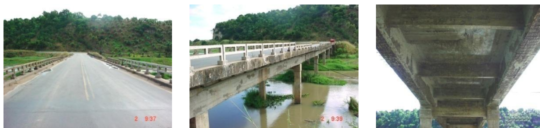
Figura 5.56 – Ponte s/ o Rio Itaunas, BR-101/ES, Km 17 – (1956) Condição de estabilidade: Precária - Condição de conservação: Precária
