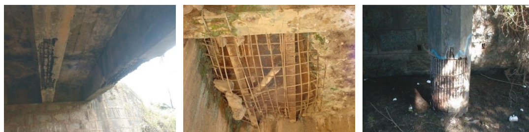
Figura 15 – Elementos problemáticos: viga, laje e pilar. Vigas da ponte s/ Rio Tapacurá, BR-232/PE, Km 50 - (1979) Laje da ponte s/ Rio Paraibuna, BR-267/MG, Km 89 - (1965) Pilar da ponte s/ Riacho Pão de Açúcar, BR-104/PE, Km 20 – (1965)
