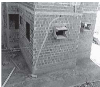
Figura 2 – Falta de compatibilização de projetos
